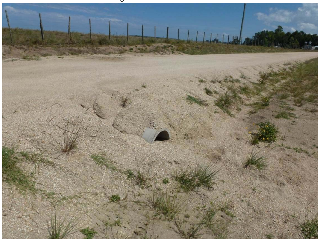
Fig. 37. Obra de arte sin cabezales semi aterrada
